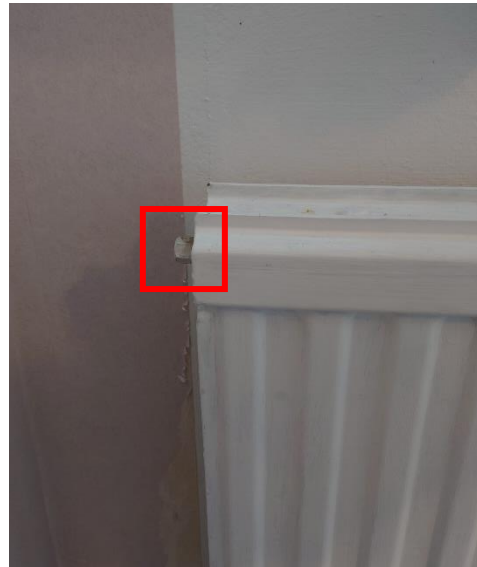
Avluftningsventil sett framifrån.
